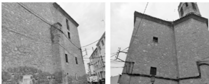
Fig.2. Contaminació visual en el lateral i darrere de l'església de la Transfiguració del Senyor.
