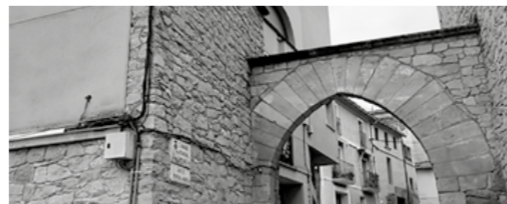
Fig.3. Cables en el lateral del Portal de Lamarca.
