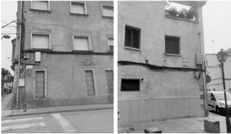
Fig.7. Contaminació visual per cables a la plaça Catalunya i al carrer Major.
